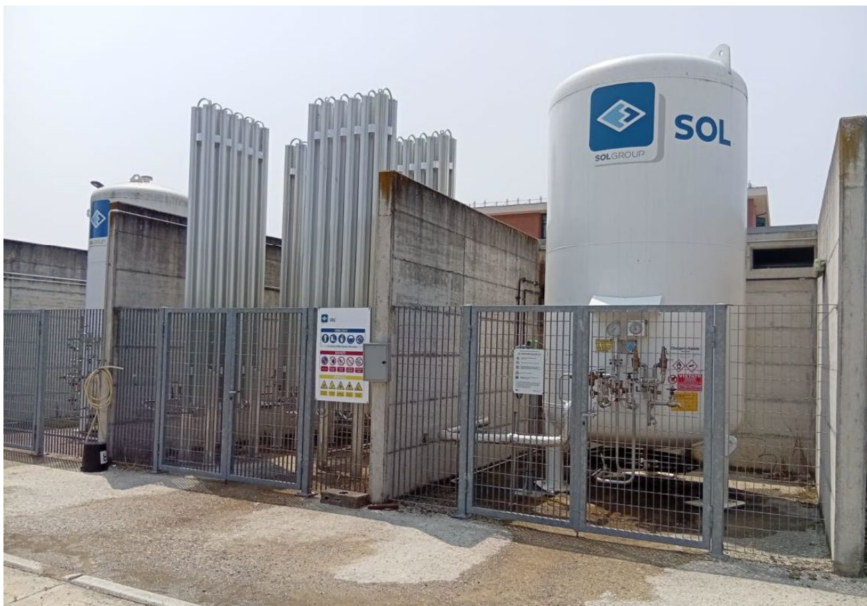
DEPOSITO GAS MEDICALI
